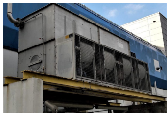
Tour aéroréfrigérante (TAR)
