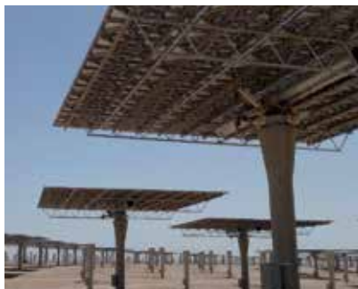
Structure en airpop® pour allègement de piédestal béton : panneaux solaires de l'usine électrique de Ouarzazate (Maroc)
