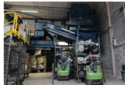
Cette nouvelle ligne de tri a été installée en 2023 pour augmenter la capacité du Relais Est. Photo R.B.
