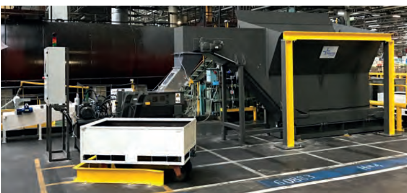
Ensemble de retraitement des copeaux aluminium :
