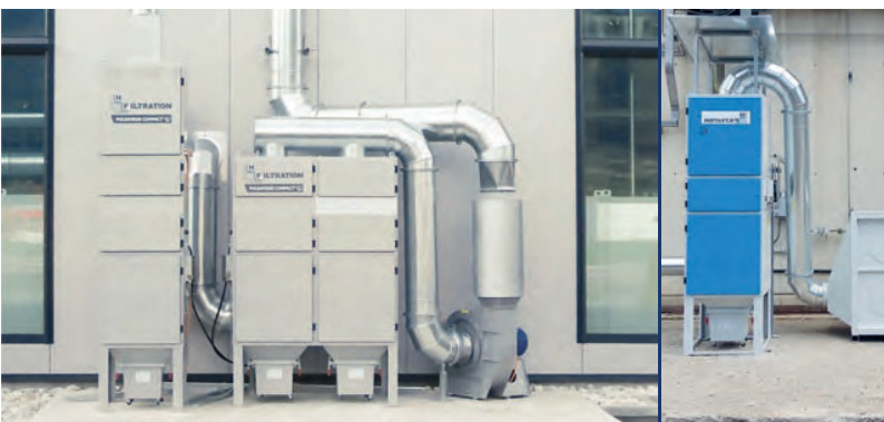
Systèmes de filtration de l'air centralisé ou unitaire
