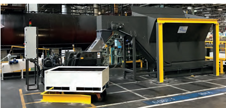
Ensemble de retraitement des copeaux aluminium :
